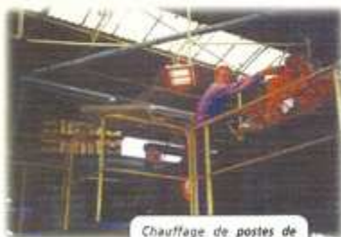
Chauffage de postes de travail dans de grands bâtiments non isolés - pilotage des radiants CQ30 par détecteur de présence humaine.
